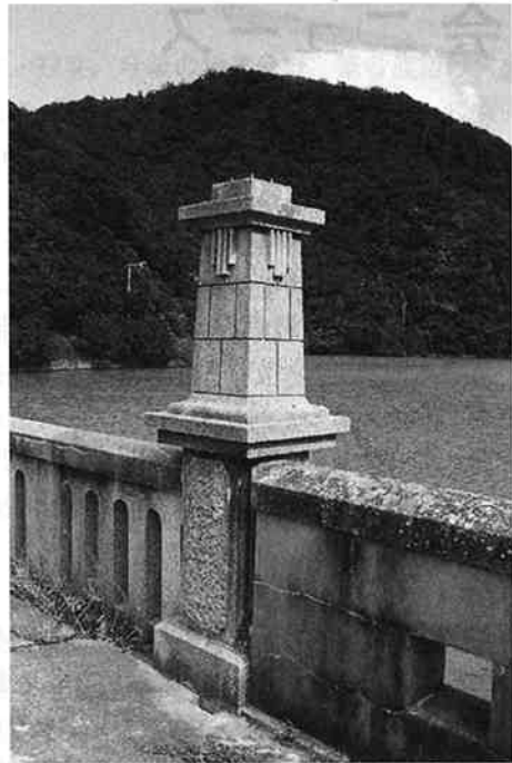
写真-3 装飾された親柱 (越流部と非越流部の境部分)
